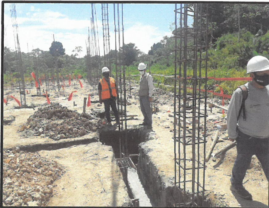
FOTO N° 13: INGENIERO RESIDENTE Y SUPERVISOR VERIFICANDO EL CORRECTO PROCEDIMIENTO DE VACIADO DE VIGAS DE CIMENTACION
